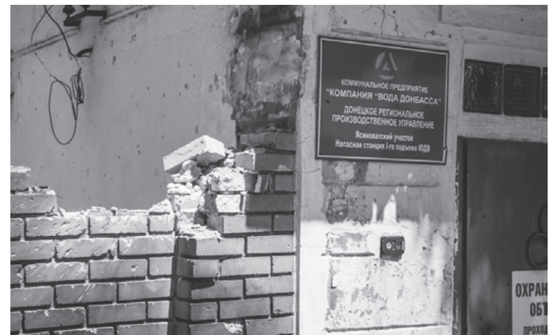
Из-за обстрелов Донецкая фильтровальная станция и насосная станция первого подъема Южнодонбасского водопровода не работали более 7 дней
